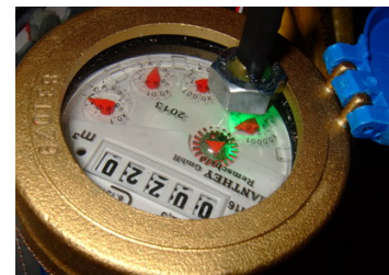
Abbildung 3.7: Befestigung der IR-Lichtschranke an einem Wasserzähler
